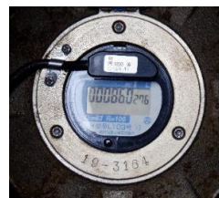
水道メーター
